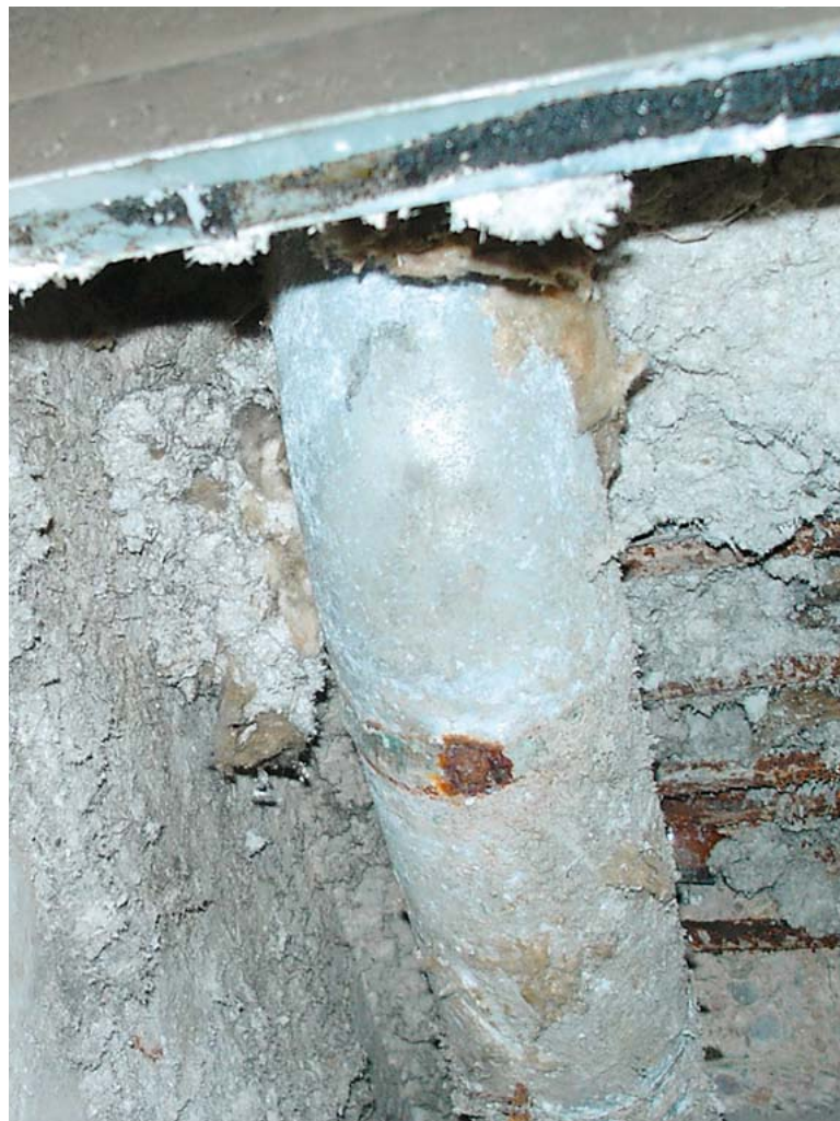
Spritzasbestanwendung in einem Versorgungsschacht.
