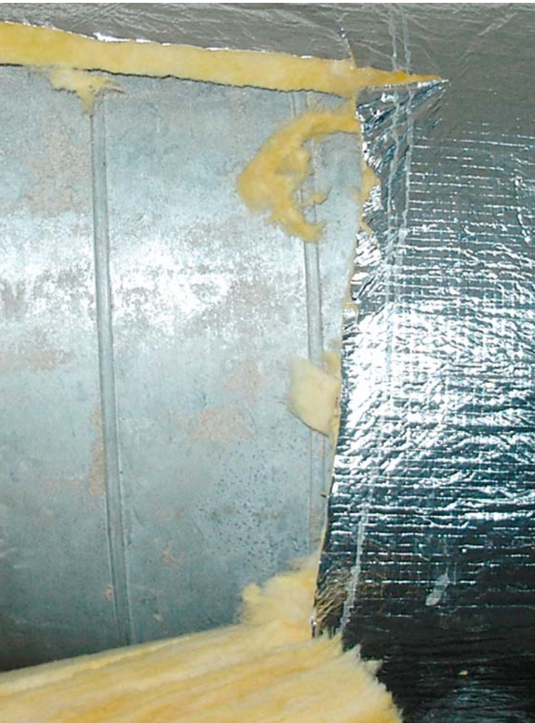
Kaschierte Mineralwolle (KMF) als Lüftungskanaldämmung.
